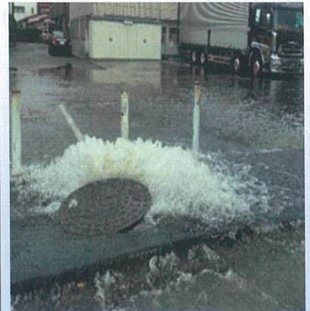
マンホールからの 雨水噴出
